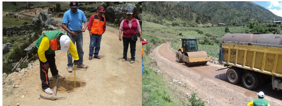
MANTENIMIENTO PERIODICO CARRETERA: HV-101 EMP. TRAMOS 2 SALCABAMBA - PLACA - SALCAHUASI - DISTRITO DE SALCABAMBA - TAYACAJA HUANCAVELICA
