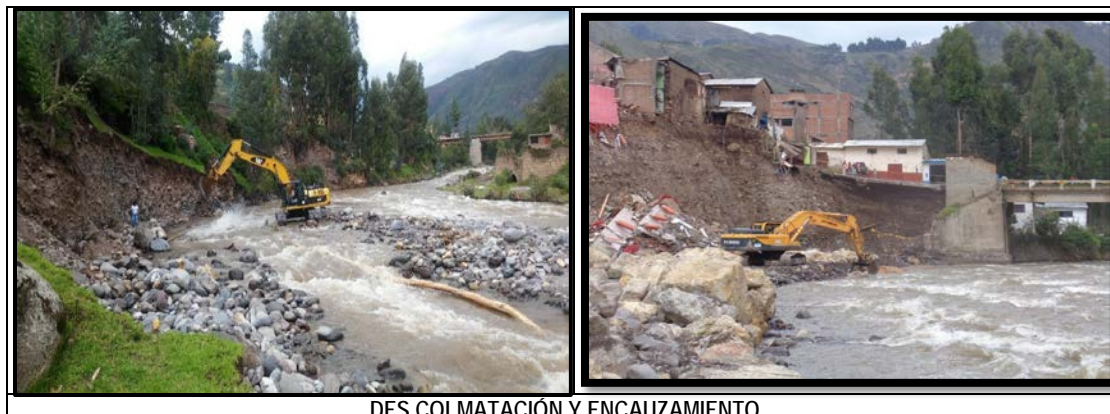
DES COLMATACIÓN Y ENCAUZAMIENTO
