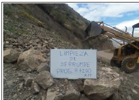
LIMPIEZA DE DERRUMBES MENORES
